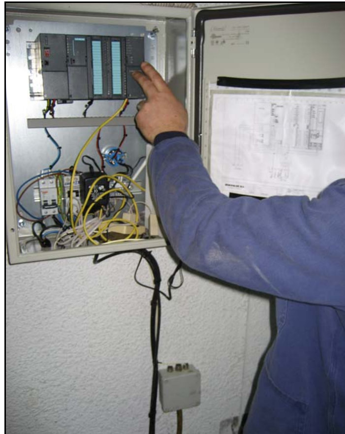
Fotografía 12-3.- Procesador de comunicaciones CP 343-1 instalado en una construcción anexa al Pozo Barredo
